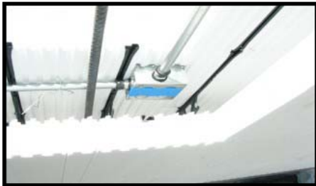
low voltage & electrical conduits
